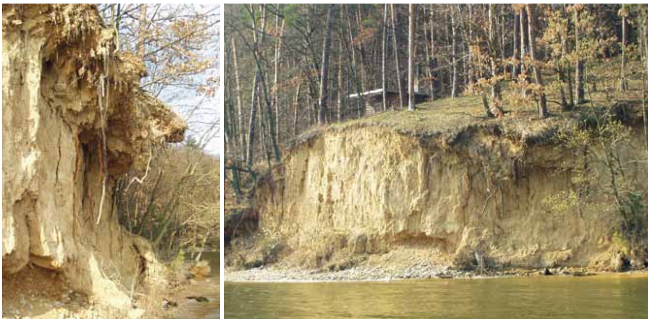
Obr. 2: Výrazně poškozený břeh v zalesněné oblasti, kde lesní porosty dosahují přímo k hladině. Nádrž Brno – Osada. Foto: M. Šlezinger
