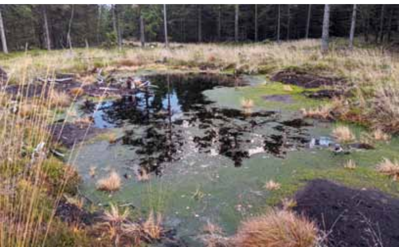
Narušené rašeliniště Phillipphaide se po šesti letech vyvíjí správným směrem (stavba rašelinných přehrázek velkým bagrem, 2013).
