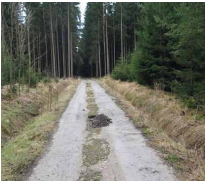
Vozovka upravená technologií KAPS-LE s půdní sondou mezi kolejemi a detail koruny cestního tělesa.
