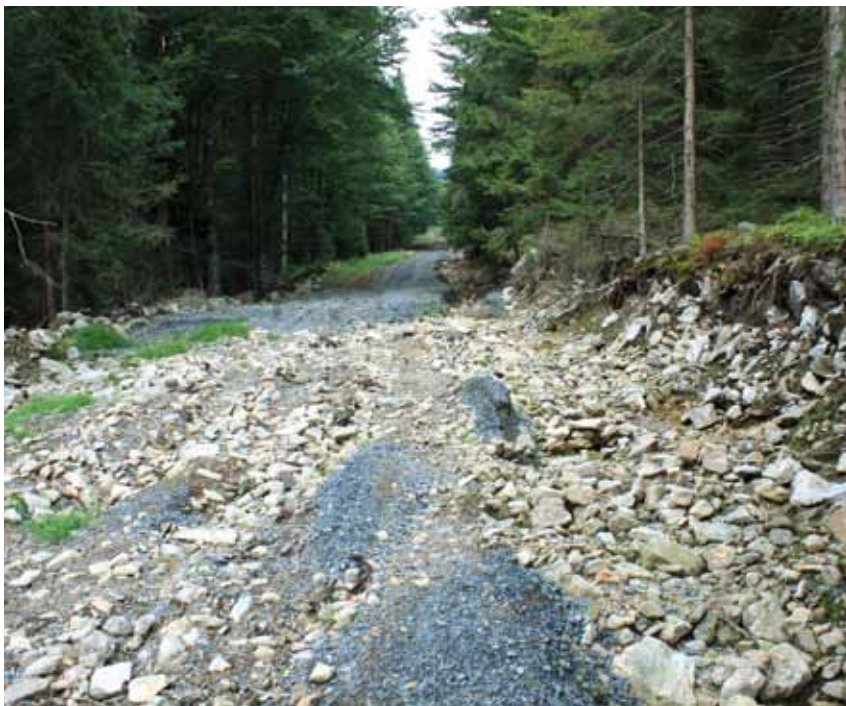
Poškození lesní cesty vodní erozí.
